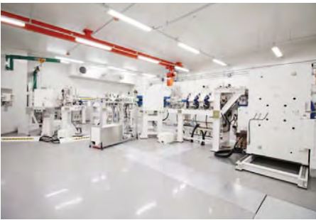
RI棟:サイクロトロン室
